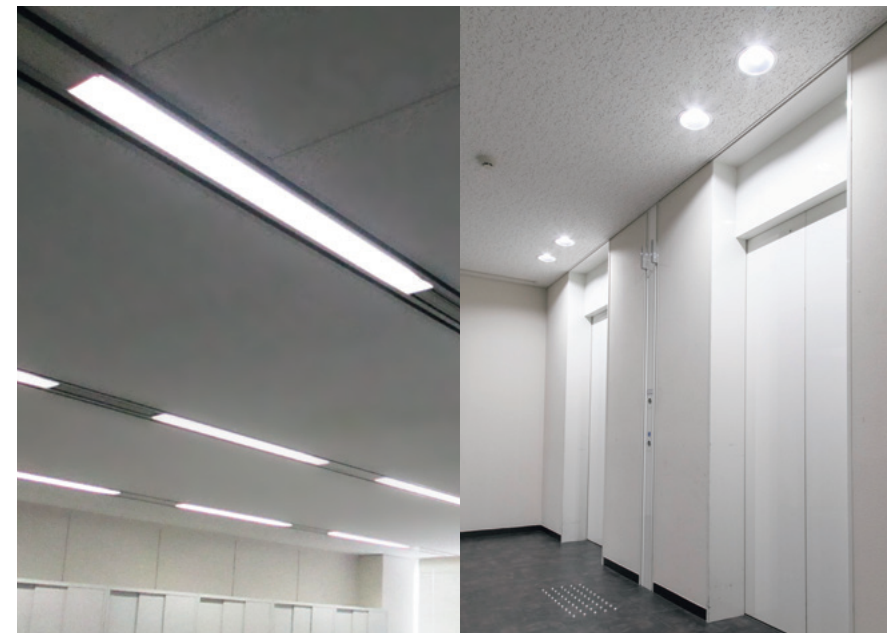
オフィス部分はシステム天井用照明器具の入れ替えを実施 共用部はLEDダウンライトに入れ替えました
